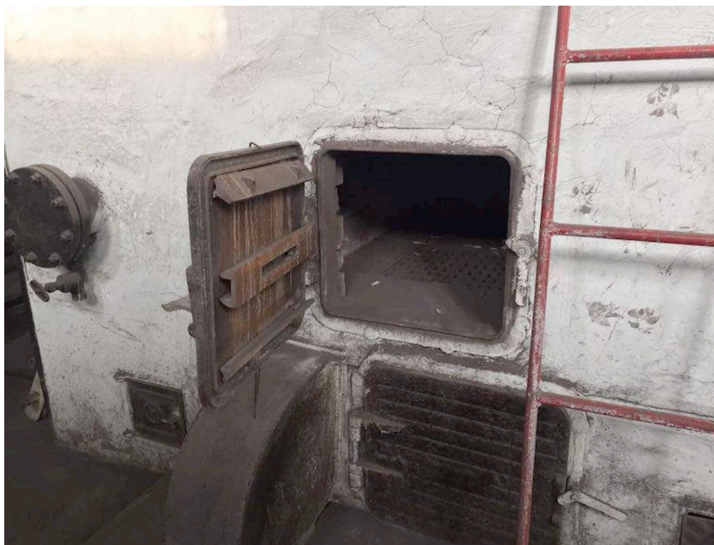
Рисунок 8 – Котел ЗИО-60 перед началом испытаний.
