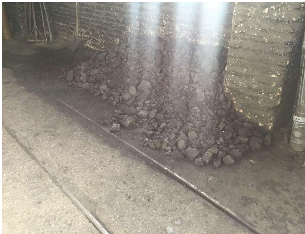
Рисунок 6 – Площадка для угля в котельной.
